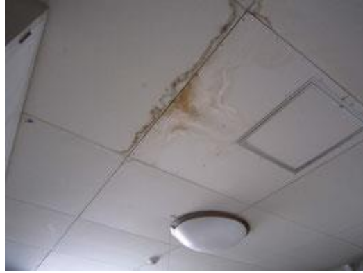
写真 11. 老朽箇所（天井）
