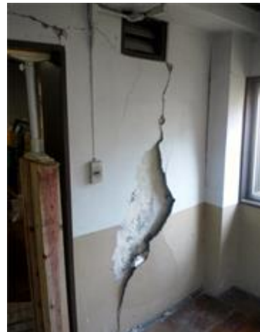
写真 3 震災で損傷した壁
